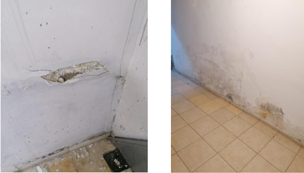
Şekil 7.6. Nem ve rutubetlenmeye bağlı gözlemlenen hasarlar
